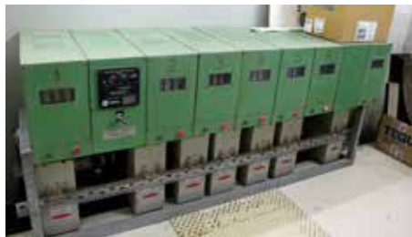
Figura 13. Batería de condensadores.
