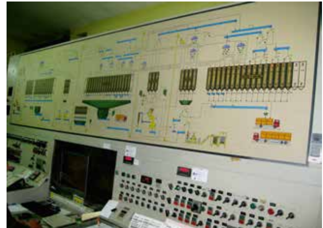
Figura 14. Panel de control.
